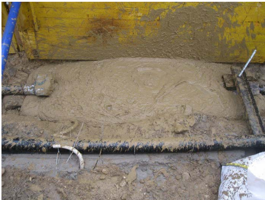
Abbildung 103: ZFSV-Verguss im Bereich einer Auftriebssicherung (Quelle: AGFW)
