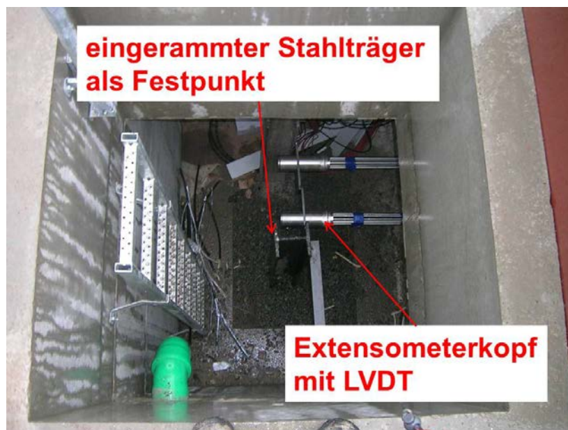
Abbildung 107: Extensometerkopf und Festpunkt im Messschacht
