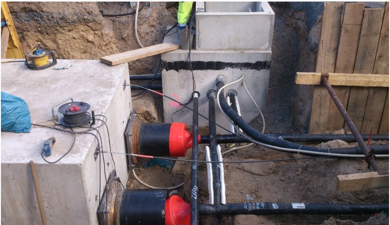
Abbildung 101: Erdfestpunkt und Anbindeschacht, (Quelle: GEF)
