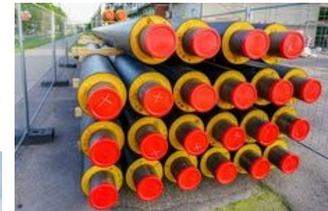
Anschlussleitungen, Netzausbau und -erweiterung: 8,1 Mrd. EUR
