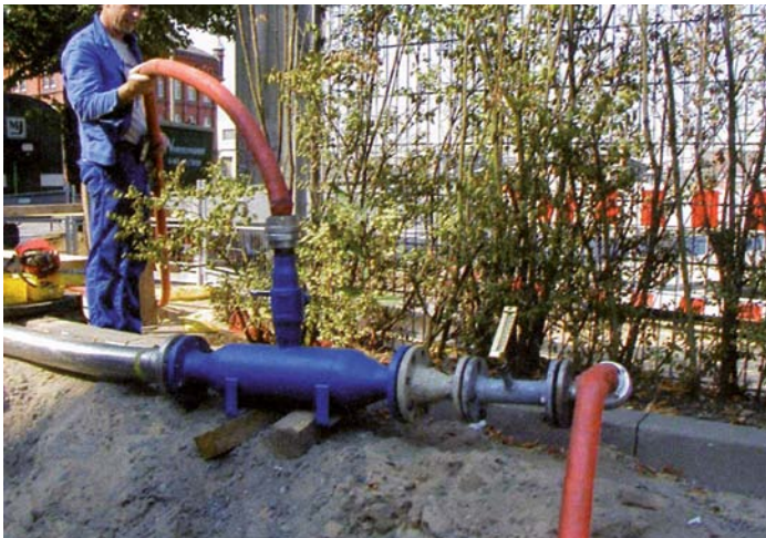
Bild 23: Abkühlen des Mediums mittels Mischkühler
