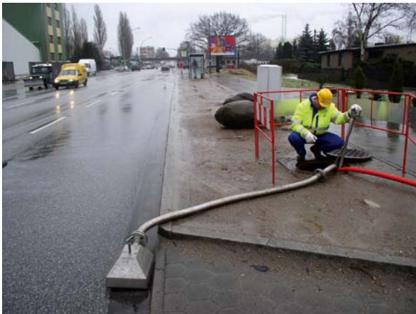
Bild 18: Kontrolliertes Freisetzen von Heizmedium über Metallschlauch
