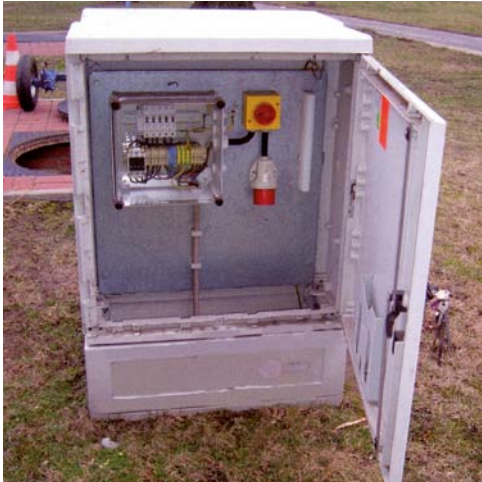
Bild 16: Speisepunkt außerhalb des Schachtes
