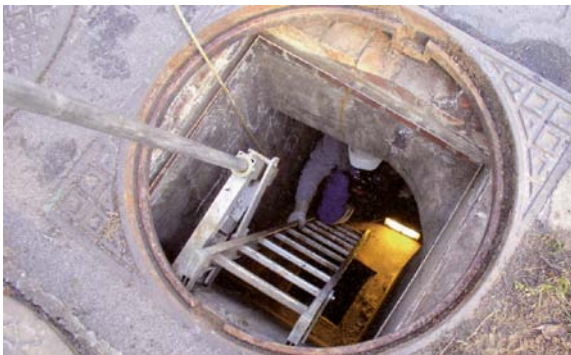
Bild 28: Sicherung des Pumpensumpfes durch Einsteigleiter
