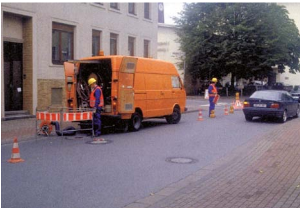
Bild 8: Mit Abspergitter gesi- cherter Schachtein- stieg
