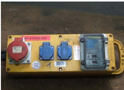
Abb. 9.2.3 Beispiel für einen Kleinvertei- ler mit Fehlerstromschutz- einrichtung zum Einsatz in leit- fähiger Umgebung. Eine Verwendung in leitfähigen Bereichen mit begrenzter Bewegungsfreiheit ist nicht zulässig.
