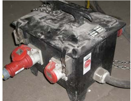
Abb. 9.2.2 Beispiel für einen Schutz- trenntransformator zum Ein- satz in leitfähigen Bereichen mit begrenzter Bewegungs- freiheit
