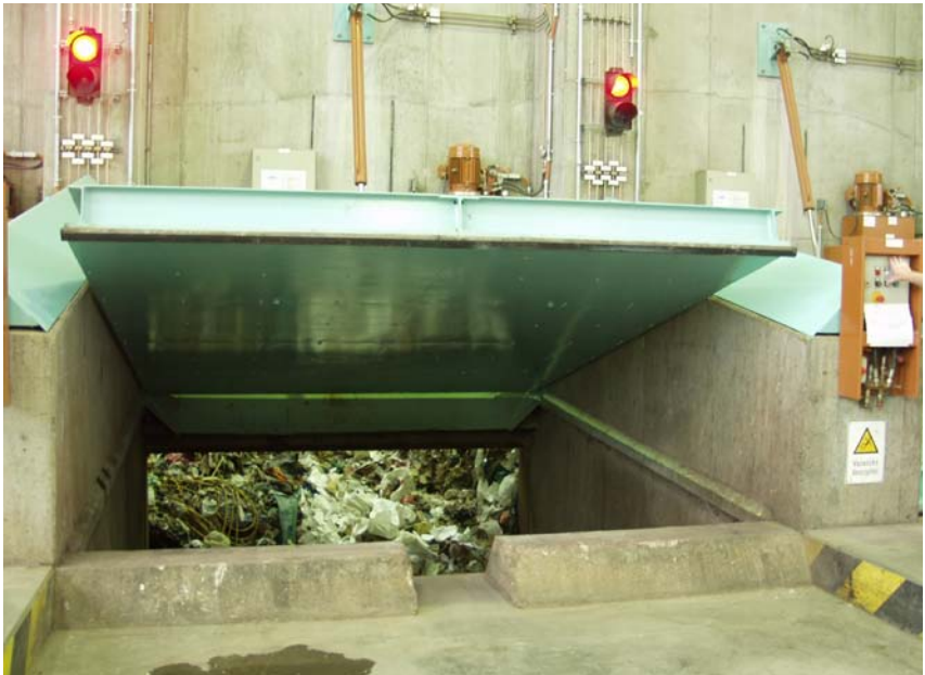
Abb. 14.1.1 Beispiel für eine Entladestelle in einen Müllbunker. Die Einfüllöffnung wird durch eine hydraulisch angetriebene Klappe von einem sicheren Standpunkt aus verschlossen. Eine zweiteilige Schwelle dient als Überfahrtschutz.
