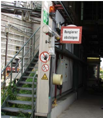
Abb. 12.1.1.1 Eingehauste Beladeanlage für Flugstäube mit Sicherheitskennzeichnung
