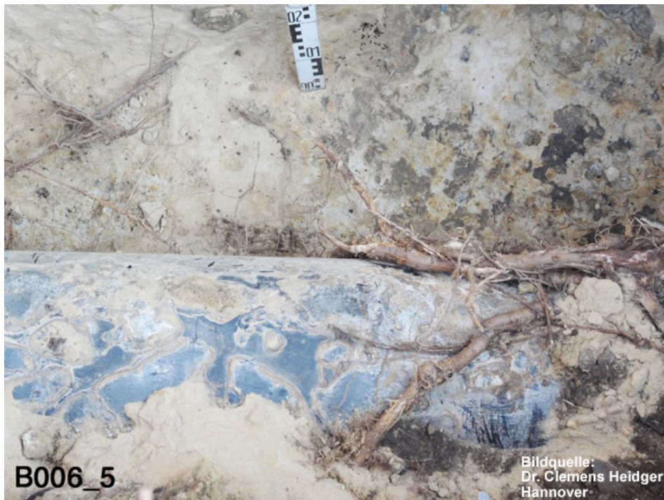
Abbildung 2: Wurzelwachstum an Fernwärmeleitungen (Quelle: Dr. Clemens Heidger)
