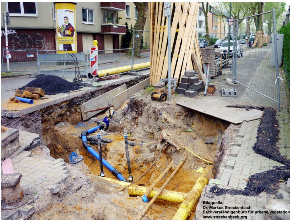
Abbildung 1: Aufgrabungen mit typischer Situation vor Ort mit Konkurrenz Situation zwischen Leitungen und Baumvegetation (Quelle: Dr. Markus Streckenbach)
