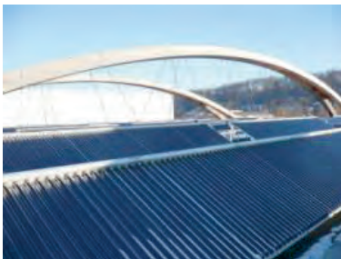
Abbildung 4-16: Solarthermieanlage Wels (Foto: IFEU)
