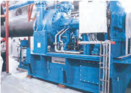
Abbildung 4-23: Großwärmepumpen in Skoyen (Foto: Friotherm 2006).
