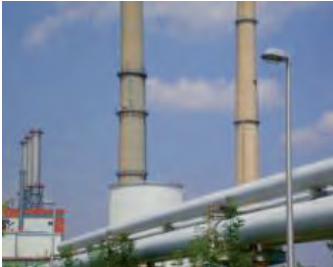
Abbildung 6-6: Heizkraftwerk Jena-Süd mit Wärmespeicher (GEF)
