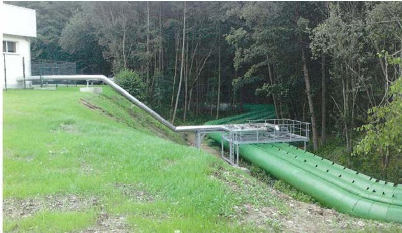
Bild 8 - Freileitung im Gelände [Quelle: inetz, Chemnitz]
