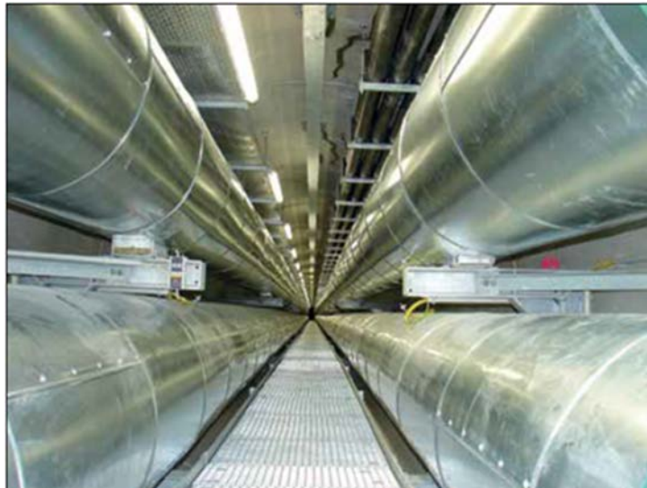
Bild 10 - Versorgungskanal, vorrangig für Fernwärmeleitungen und weitere Medien [Quelle: EuroHeat&Power, Heft 1-2, 2018]
