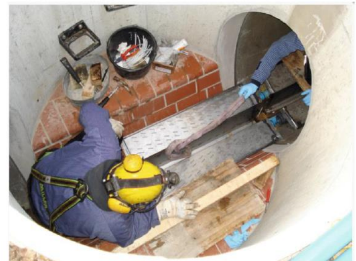
Bei nachträglichem Einbau wurden die Wärmeübertrager als Einzelelemente im Kanal zusammengesteckt Foto: Ulling Kanaltchnik
