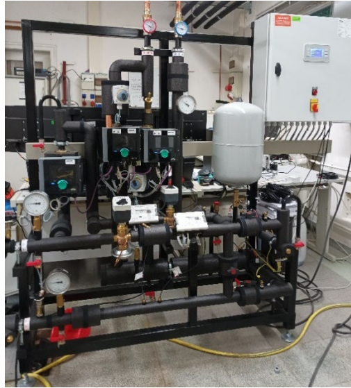
Abb. 2.4: Prototyp der bidirektionalen Wärmeübergabestation im Labor
